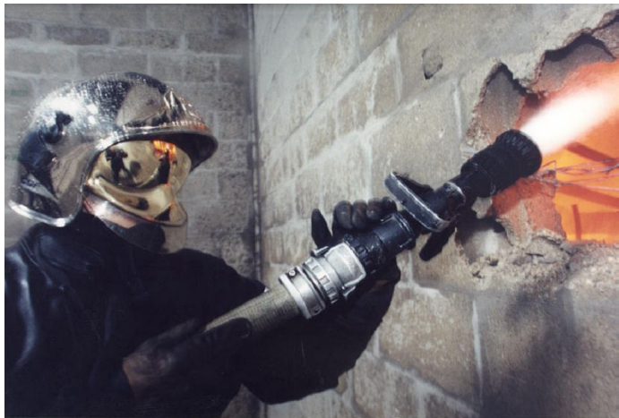
Trouée dans un mur Coupe-Feu (source CIMBETON)
