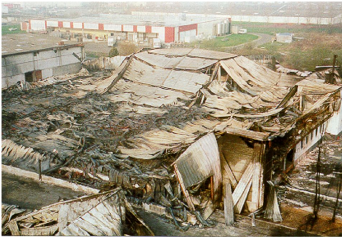
Les risques d'effondrement sont permanents et les risques de pollution sont réels (source CIMBETON)
