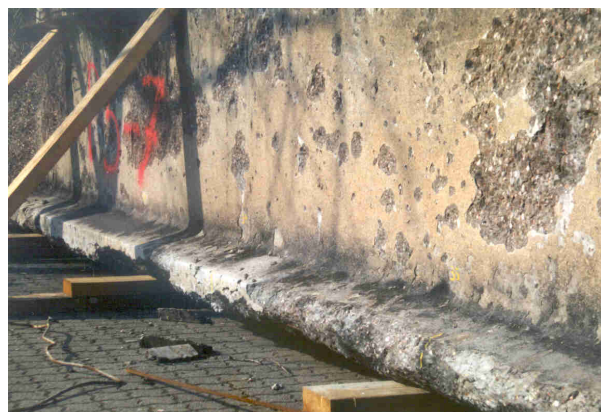
Ecaillage du béton des poutres maîtresses (source : FEBELCEM).
