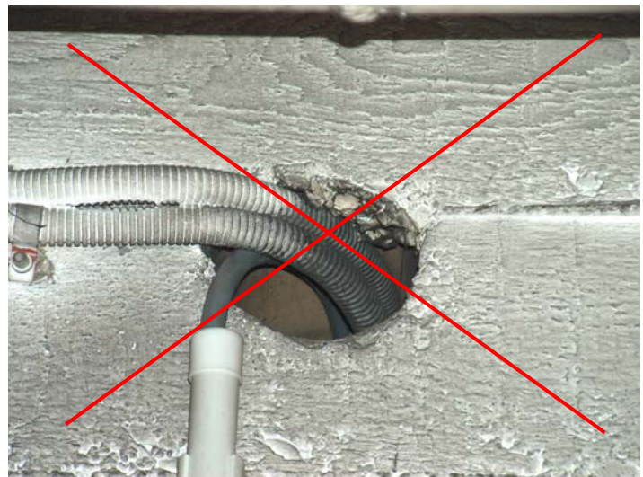
A proscrire ! Une ouverture dans une paroi EI laissant passer des câbles électriques et qui n'a pas été rejointoyée (source [8])
