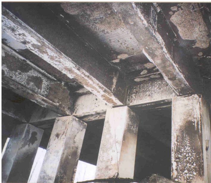
Dessous du tablier du pont après l'incendie (source : ANPI).
