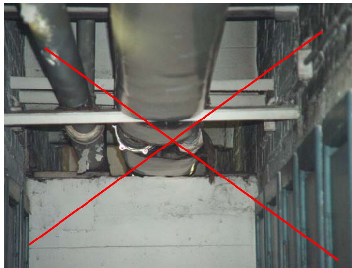
Paroi non re-maçonnerie dans une paroi EI, au niveau des canalisations de chauffage la traversant (source [8])
