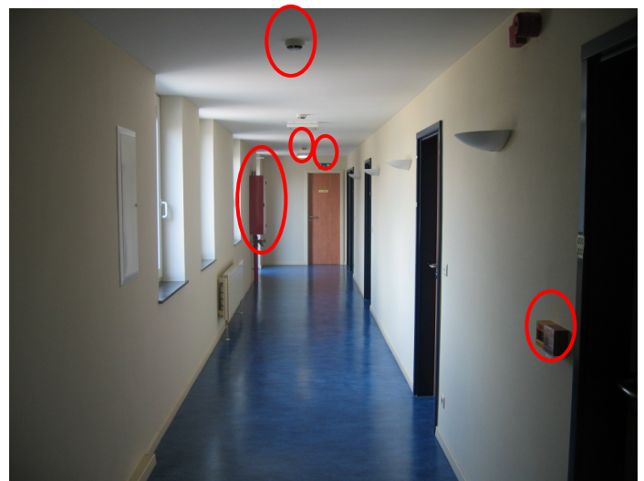
Dans ce couloir bon nombre d'éléments de protection active sont présents : dispositif d'alerte, dévidoir, panneau de signalisation, détecteur de fumées, éclairage de secours (source : FEBELCEM)
