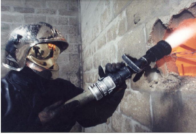
Gat in een brandmuur (bron CIMBETON)
