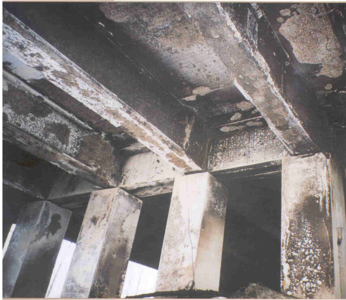
Zicht onder het brugdek na de brand (bron : ANPI).
