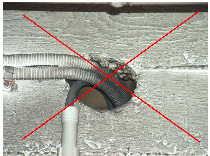
Te vermijden ! Een opening in een wand met EI-eis waardoor elektriciteitskabels lopen en die niet opgevoegd werd (bron [8])
