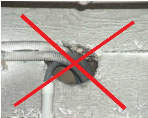
Niet toelaatbaar! De opening in een EI-wand werd niet opnieuw dichtgemaakt [22]
