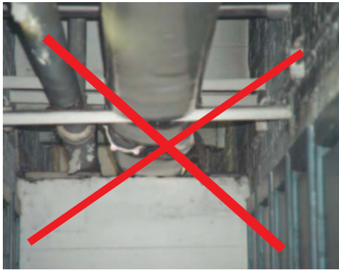
Mur non remaçonné dans une paroi EI, au niveau des canalisations de chauffage la transversant [22]
